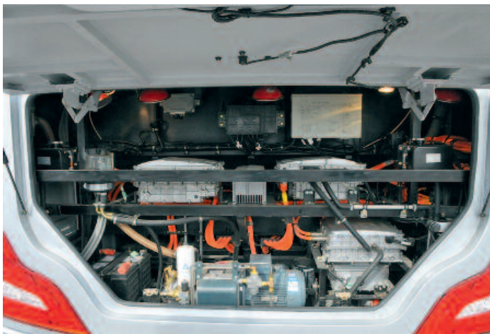
▲ Im Motorraum finden sich ausschließlich elektrische Aggregate und Verbindungen zu den dahinter integrierten Batterien
