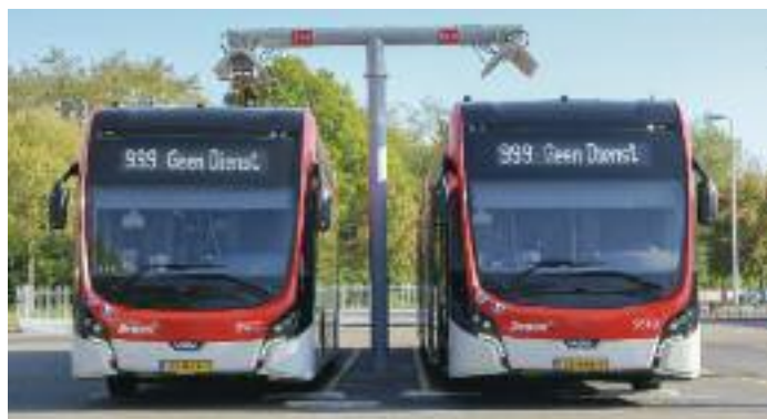
⬆ Schnelllader mit jeweils 300 kW Leistung versorgen die Fahrzeuge beim Opportunity-Charging. Hier zwei der sechs Schnelllader vor der Halle, mit denen auch Nachtbusse geladen werden können, wenn die Depots am Abend verschlossen werden
