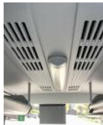
Ein elektrischer Entlüfter unterstützt die Luftzirkulation im hecknahen Hochbodenbereich
