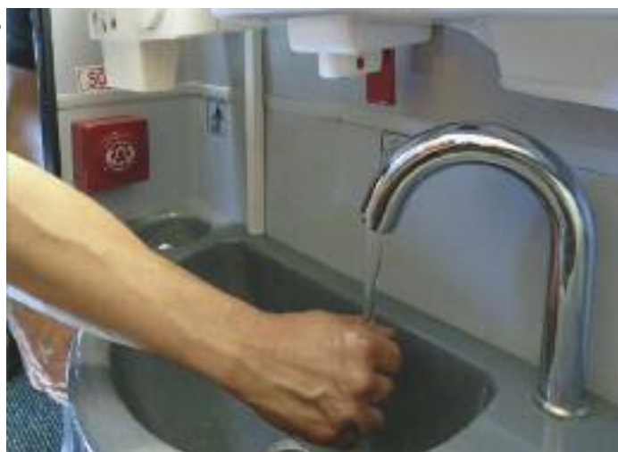
▲ Auf wechselnde Fahrgäste ausgerichtet: Bord-WC mit robuster Ausstattung, wozu sogar ein elektrischer Handtrockner gehört
